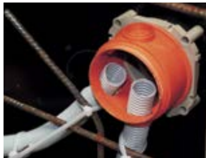
Корпус KBV и подведенные в него трубы.
